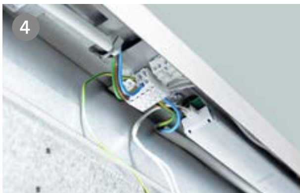
Het aansluitsnoer wordt aangesloten op een 5-polig klemblokje voor doorvoerbedrading.
